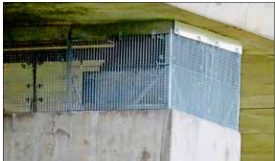
Abbildung 8: Verschlussene Pfeilerköpfe, Foto: M. Geib
